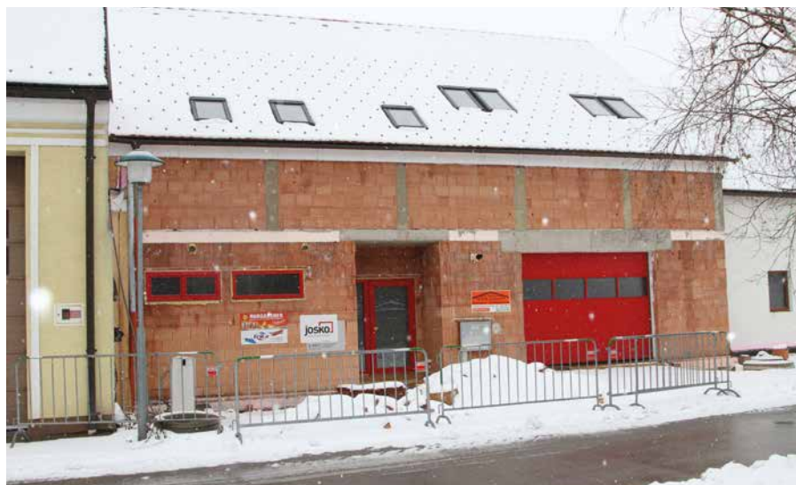
Die aktuell größte Baustelle der Großgemeinde: der Zubau des FF-Hauses und Bau des DEV-Stadls. Vom Land NÖ wurden € 200.000,- zugesagt und bereits zur Hälfte ausbezahlt.
